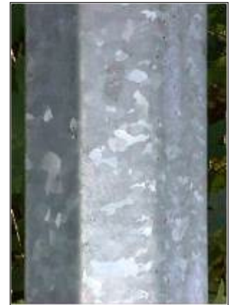
poteau de lampe protégé par zincage
