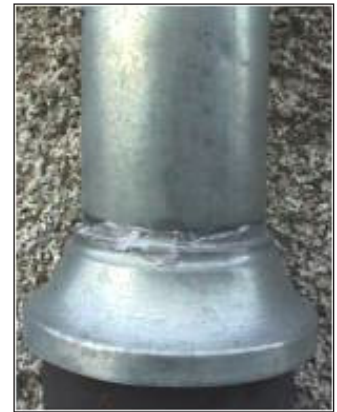
tuyau de gouttière en zinc, soudé à l'étain
